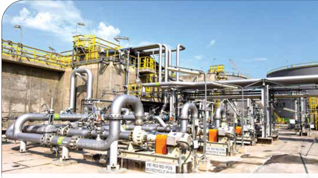
● وحدة معالجة مياه الصرف الصناعي في مشروع الوقود البيئي (U-163)
