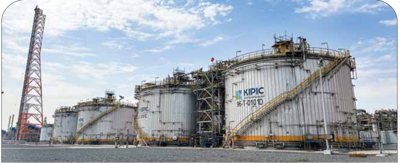
● المصفاة تتمتع بقدرة تخزينية عالية لمنتج زيت الوقود منخفض الكبريت
