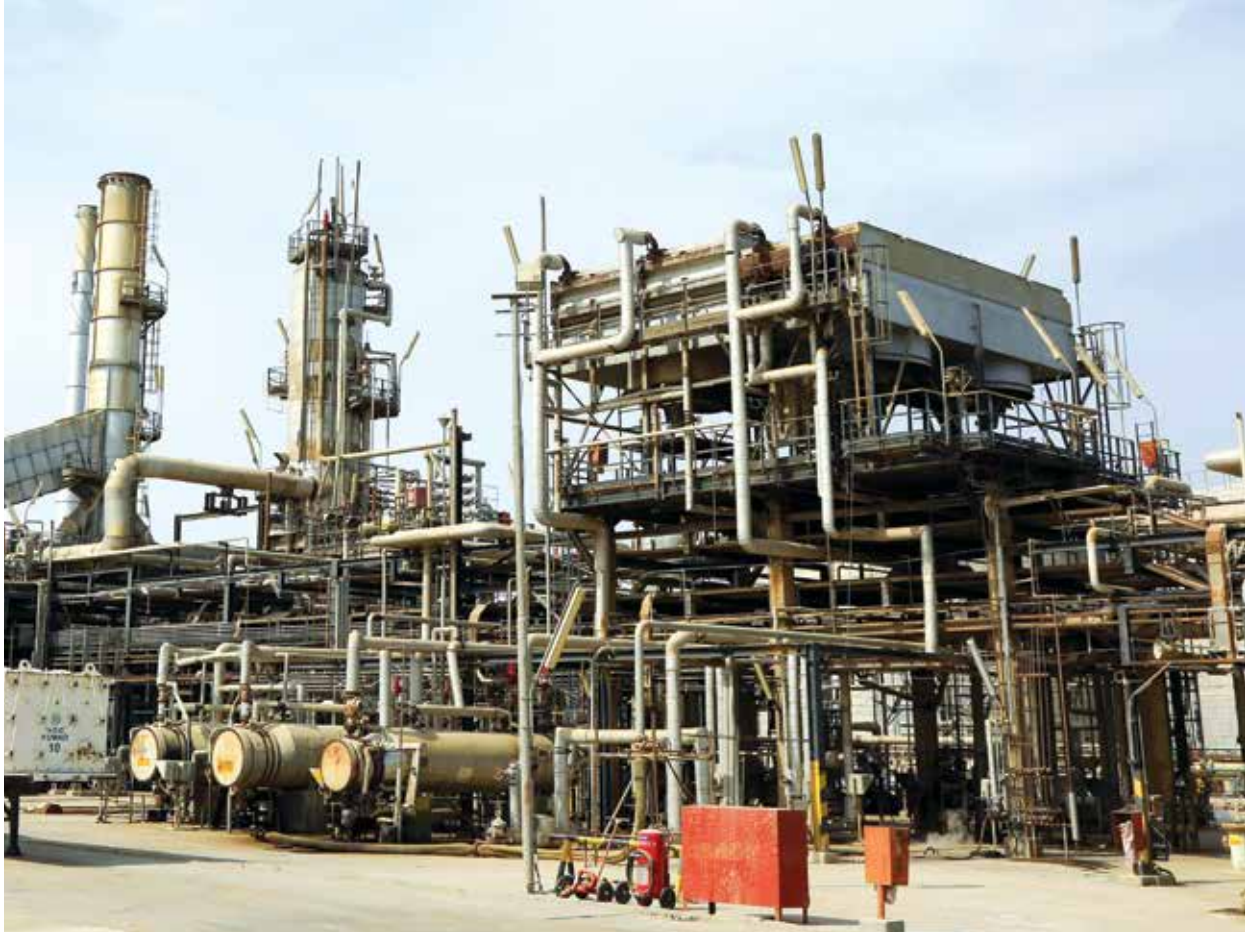
وحدة إنتاج البيتومين
