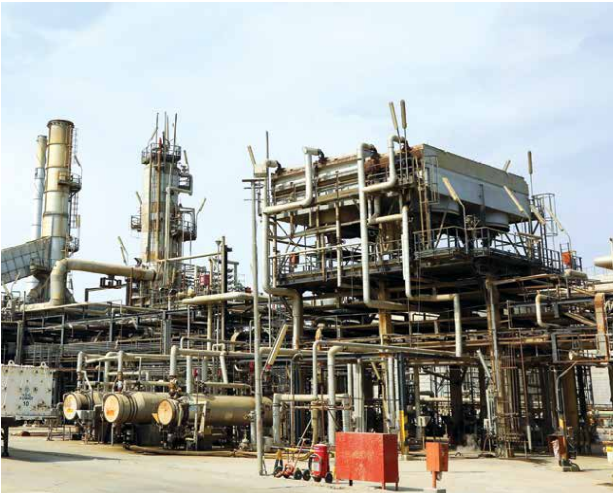
Bitumen Production Unit
