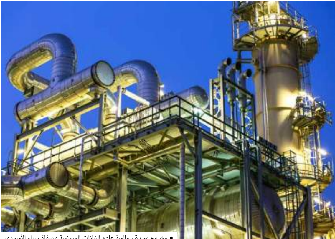
• مشروع وحدة معالجة عادم الغازات الحمضية بمصفاة ميناء الأحمدى
